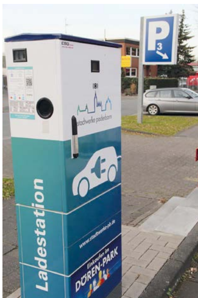
Ladesäule Senefelder Straße
